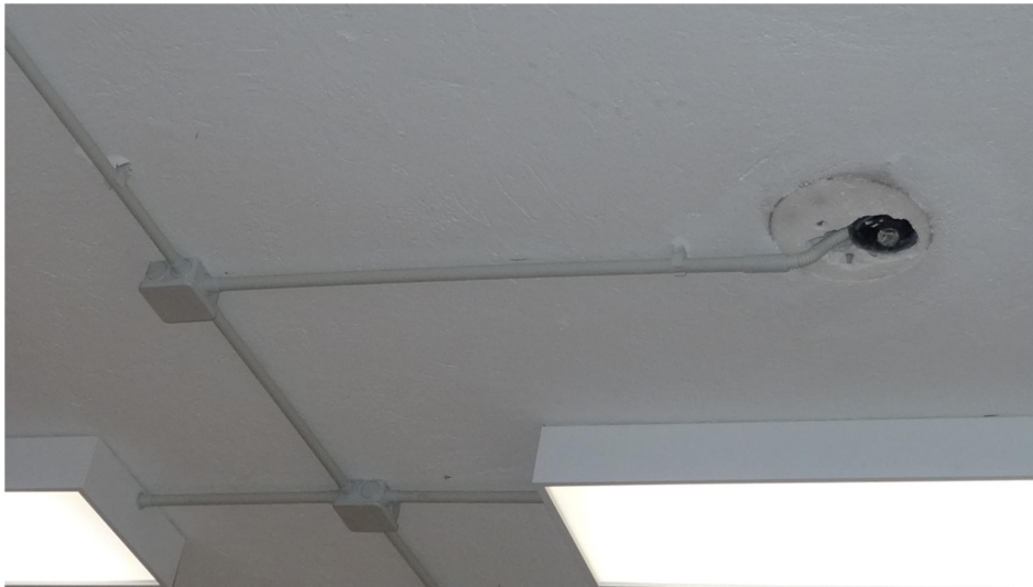
Εικόνα 17: Νέα σώματα φωτισμού.
