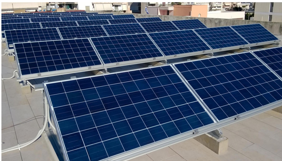
Εικόνα 14: Η φωτοβολταϊκή εγκατάσταση του 2ου Λυκείου Μοσχάτου.
