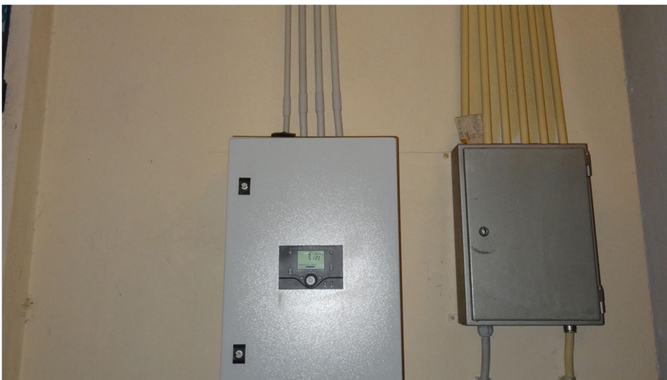
Εικόνα 18: Σύστημα αντιστάθμισης λέβητα.
