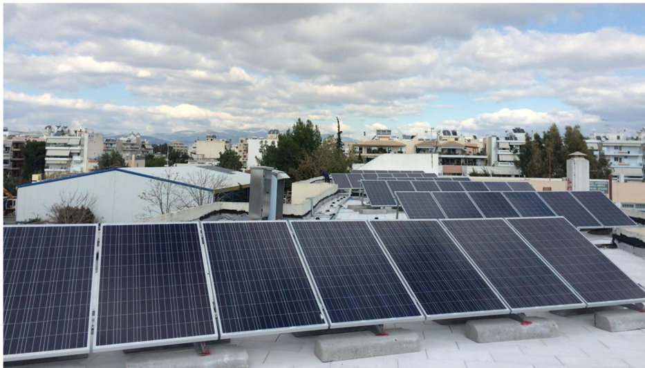
Εικόνα 13: Η φωτοβολταϊκή εγκατάσταση του 2ου Λυκείου Μοσχάτου.
