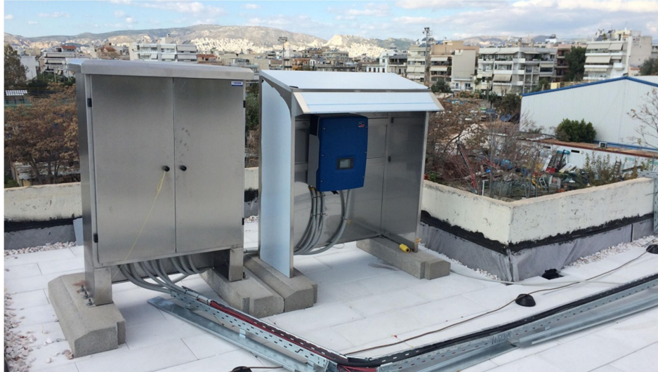
Εικόνα 15: Ηλεκτρολογική εγκατάσταση φωτοβολταϊκών 2ου Λυκείου.
